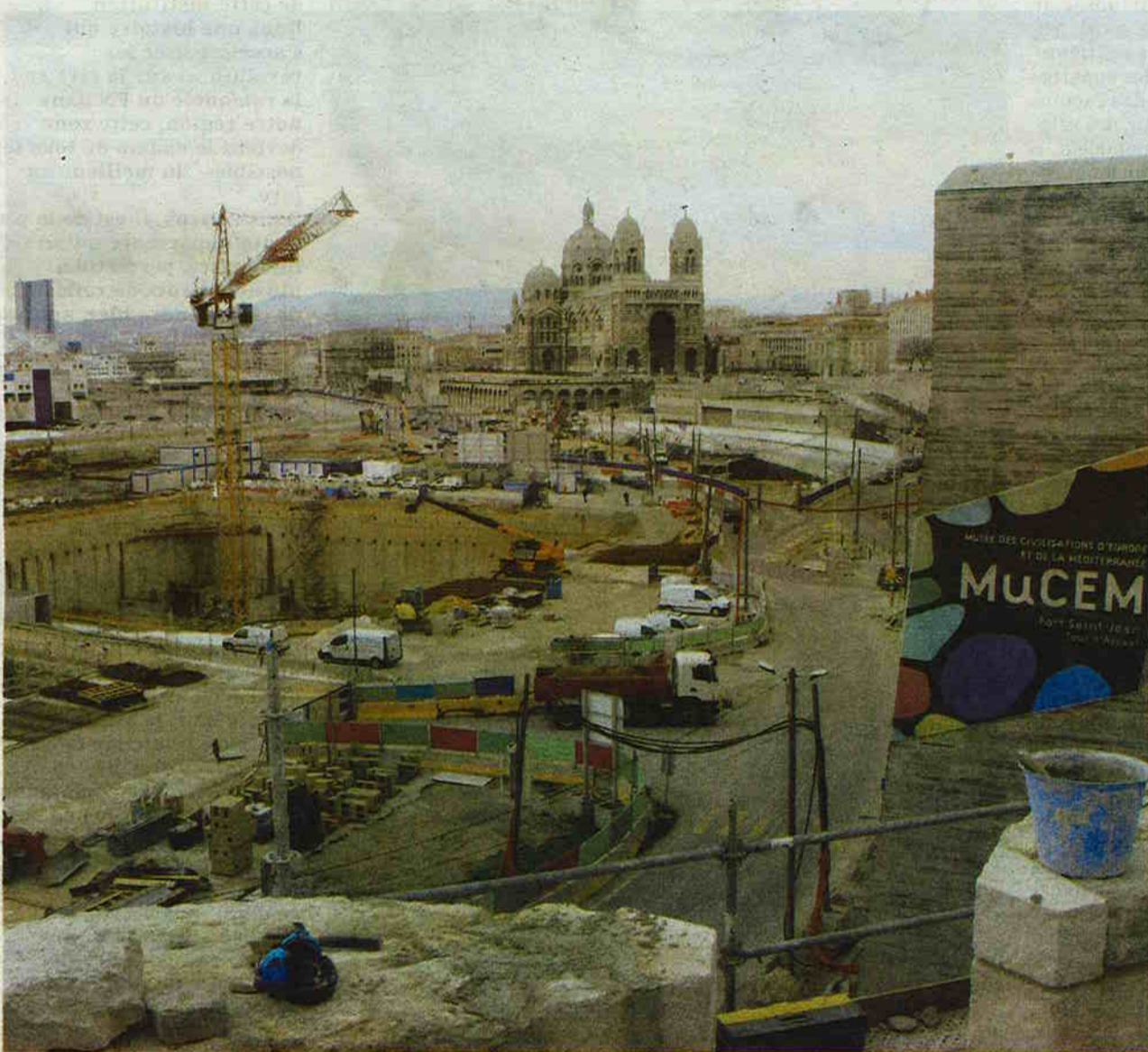
Alors que le chantier bat son plein, le Mucem construit son avenir. MIGUÉ MARIOTTI
